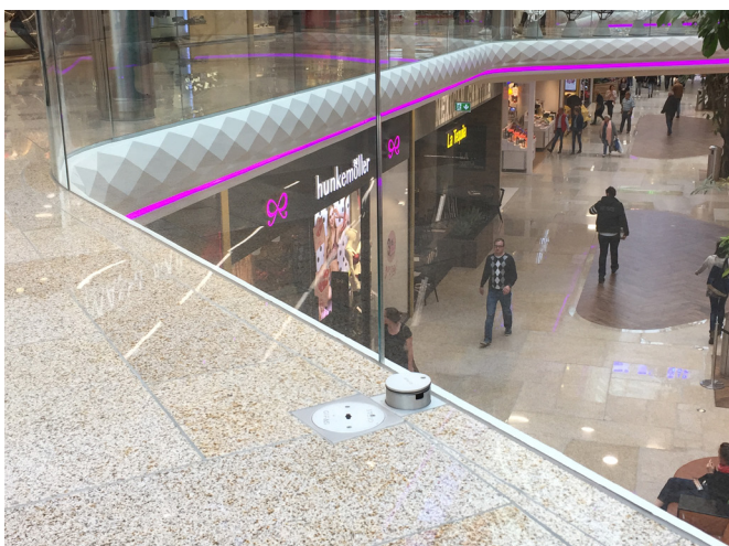
Boîtier de prises souterrain Fonto et Masso, centre commercial Plus City
