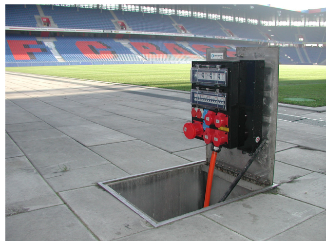
Distribution électrique souterraine, Parc St-Jacques, Bâle
