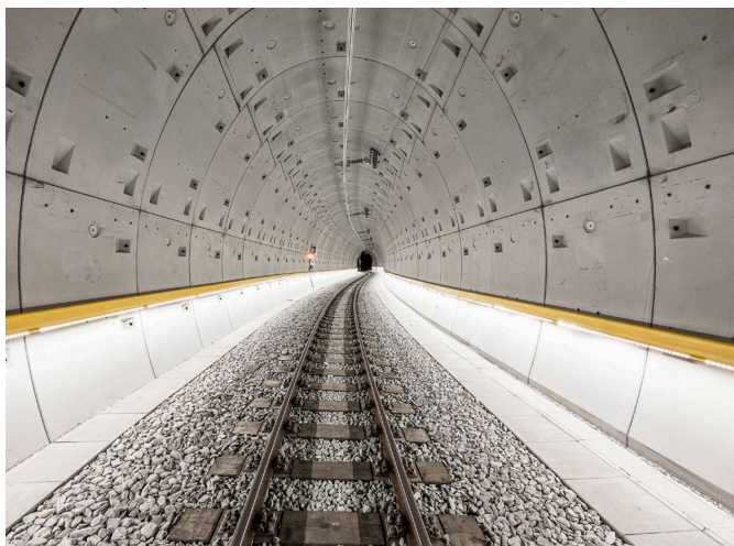
LaneLED GFK, tunnel Glatscheras
